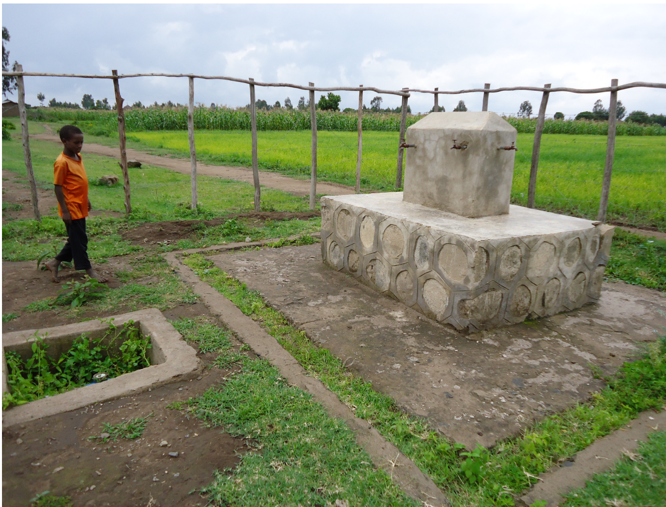
Vodní vrt před zahájením opravy.
