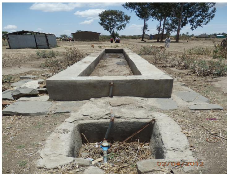
Vodní vrt před zahájením opravy.
